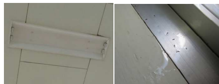
死角の例2：天井裏のトビムシが蛍光灯の隙間からエアコンの風に流され、窓のサッシに落下
